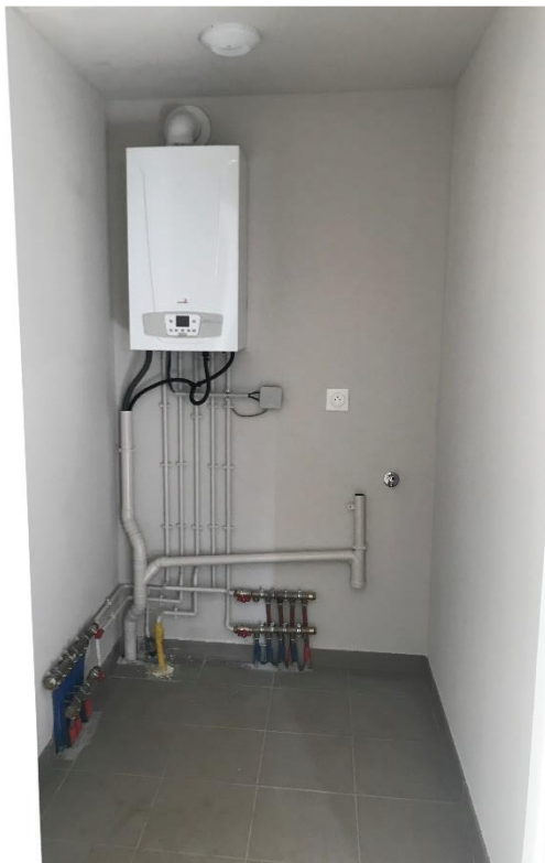
Gas-Brennwertkessel für Heizung und Brauchwarmwasser
