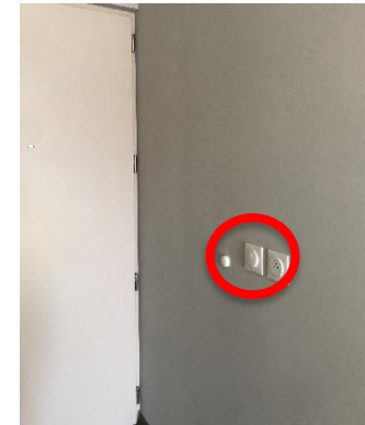
Zentrale Betätigung der Rollläden im Eingangsbereich
