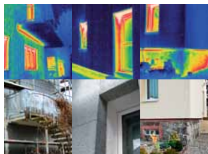
Abb. 56: Foto- und Thermografieaufnahmen von massiven Wärmebrücken bei einer Gebäudesanierung: dämmstoffdurchstoßende Balkonplatte (1); ungedämmte Fenster- und Türleibung (2); ungedämmter Sockel aus Bruchsteinmauerwerk (3).
