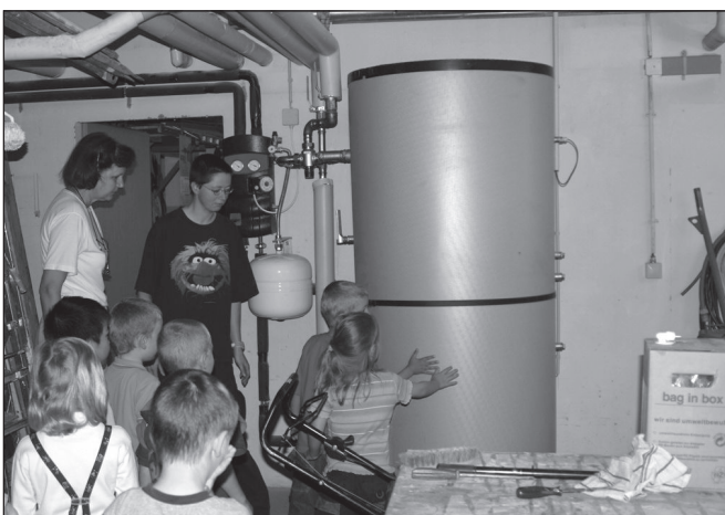
Abb. 18: Der Speicher der thermischen Solaranlage, Kindertagesstätte „Sonnenschein“
